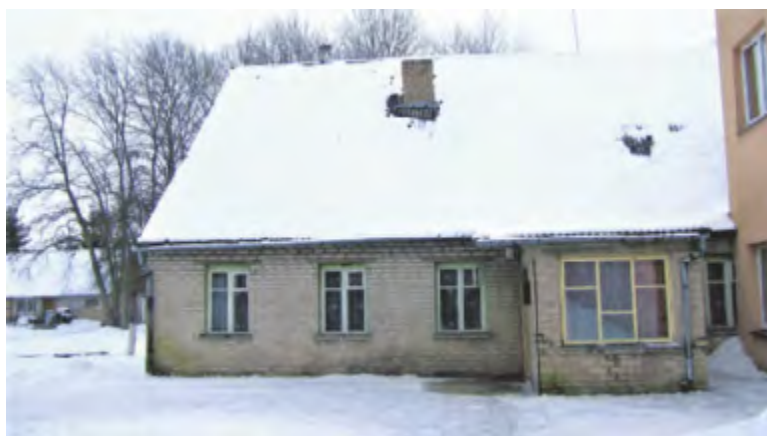
Das marode Gebäude.
